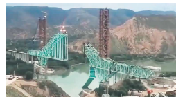
图为事故现场
